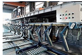
自動パイラー（搬出用受け台）
