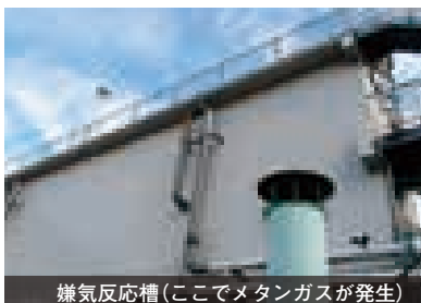
嫌気反応槽(ここでメタンガスが発生)
