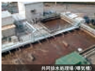
共同排水処理場 (曝気槽)
