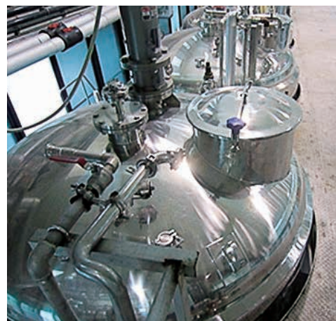
導入した堅型攪拌槽
