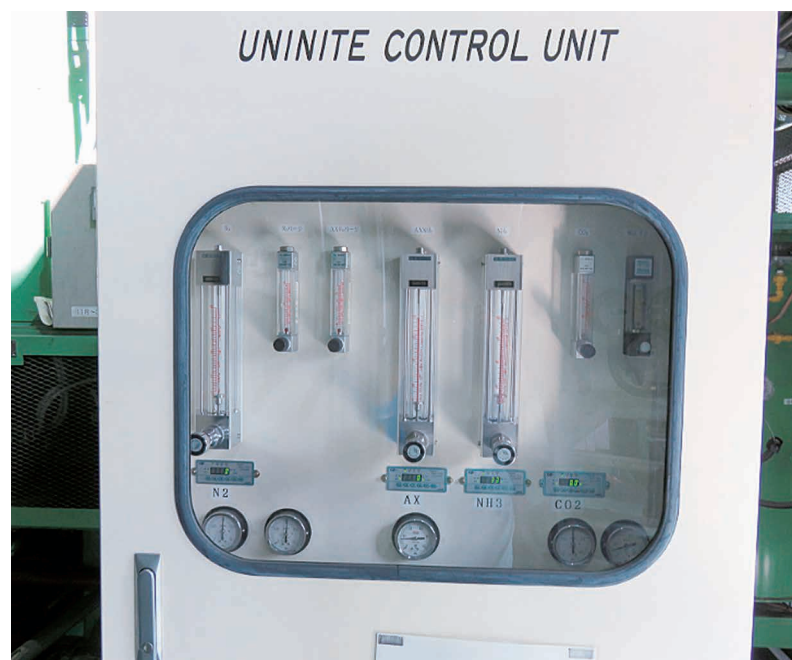
自動制御システム
