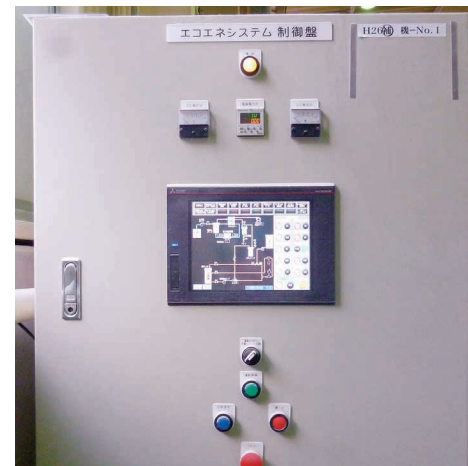
エコエネガスシステム外観
